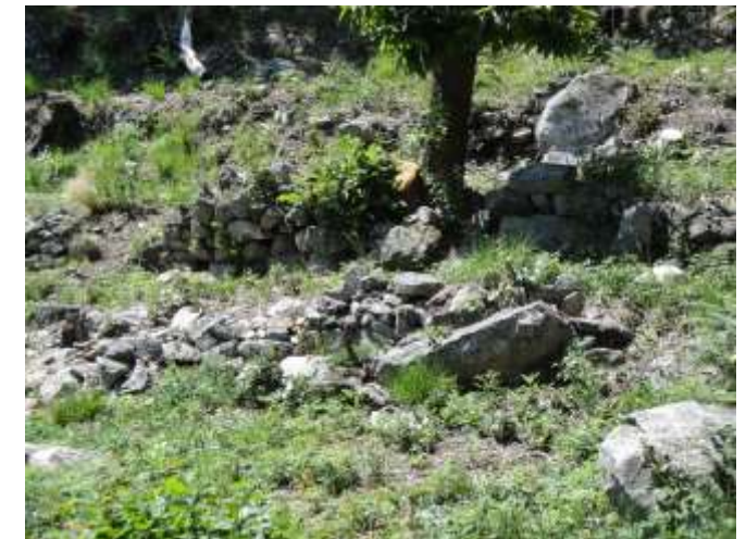
Vorher: Zerfallene Stützmauern.....
